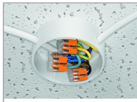
Puszka rozdzielcza do zasilania oświetlenia sufitowego
